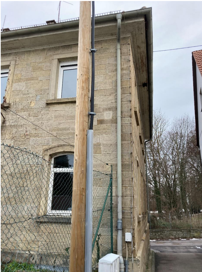
Dachgesims Süd schadhaft
